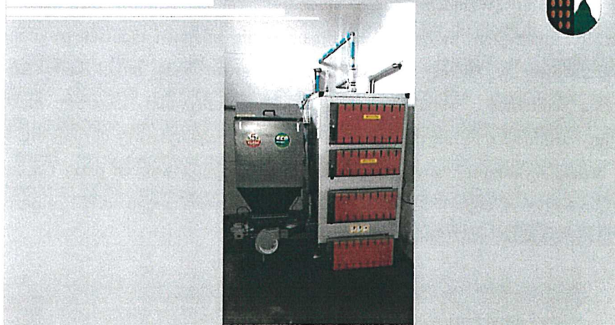
Wymiana pieca C.O i remont kotłowni budynku Gminnego Ośrodka Pomocy Społecznej w Sulikowie
